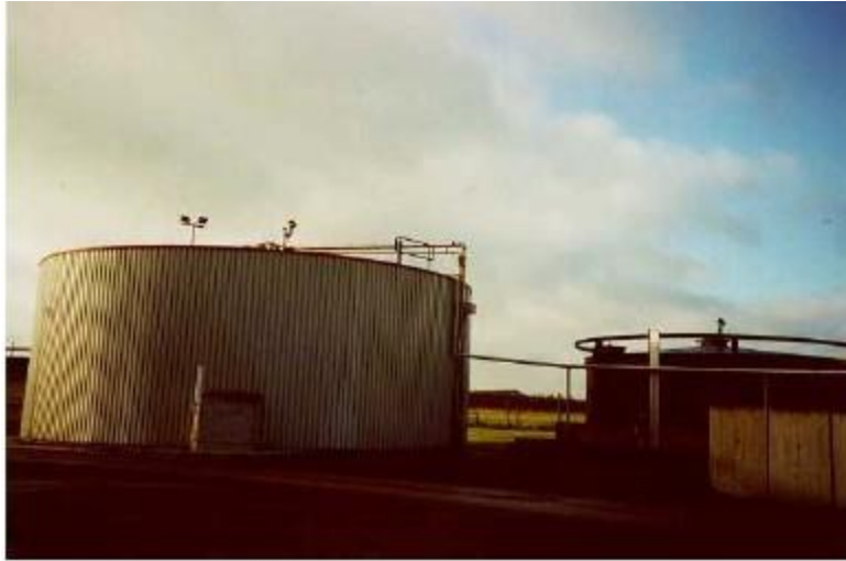
Digester pour le traitement des boues à la station de Marche (Belgique) et utilisation du biogaz dans des chaudières (ci-dessous)
